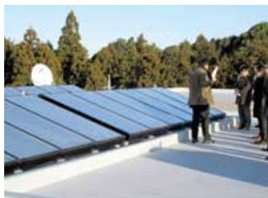
▲屋上に設置された太陽光パネル
